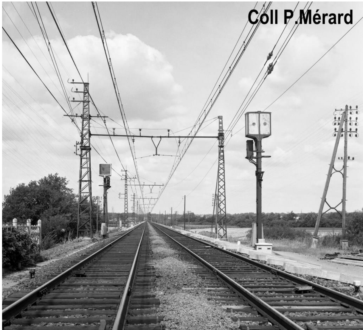
Sémaphores de Block Automatique P.D. vue de face et de derrière. 1968.
